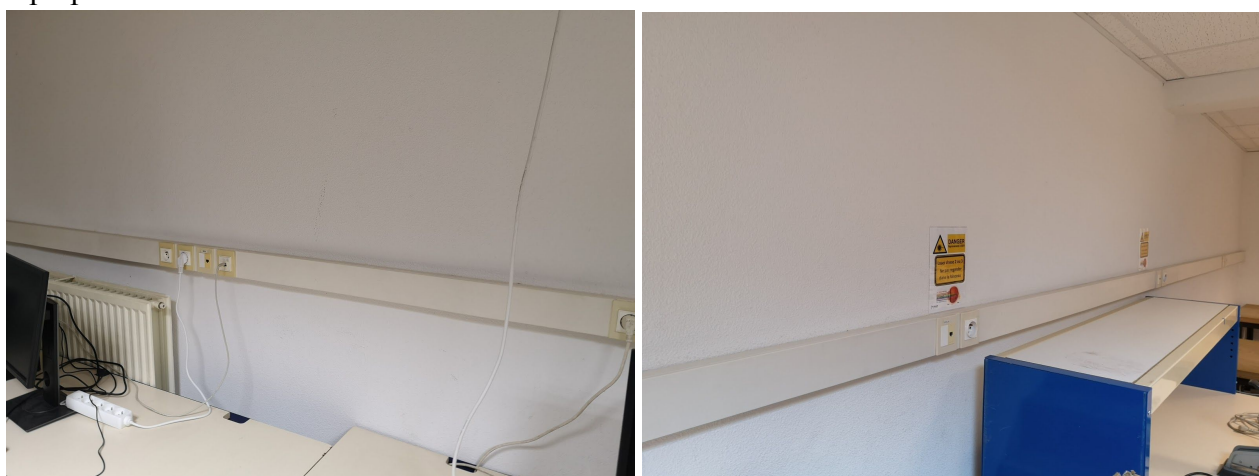
Figure 27 : Installation actuelle des goulottes de câbles
