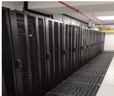
Figure 23 : Data-Center de Luminy
